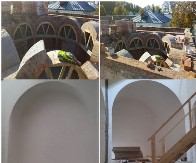
Рисунок 5 – Сводчатые кирпичные арки на отметках 8.22-9.75 в осях 3-6
